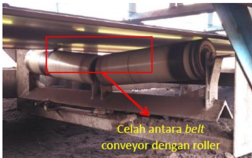
Gambar 10. Kondisi Belt Conveyor tidak sepenuhnya menyentuh dengan roller
