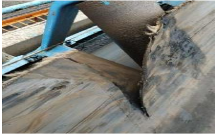
Gambar 9. Sambungan Terkelupas Bekas Gesekan Dengan Frame Idler/Roller
