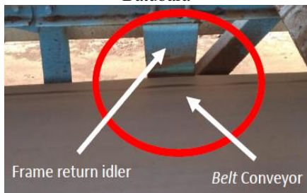
Gambar 5. Kontak antara Belt Conveyor dengan Frame
