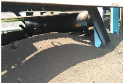
Gambar 4. Kondisi Steering Return Tertimbun Batubara
