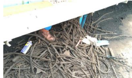
Gambar 7. Sobekan Belt Conveyor Yang Terkiki Frame Tajam
