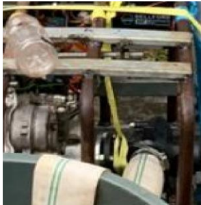
Gambar 14 : Belum Menggunakan Penyangga Rumah Pompa
