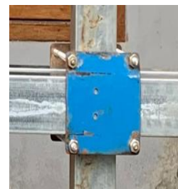
Gambar 11: Deformasi Pada Bracket.
